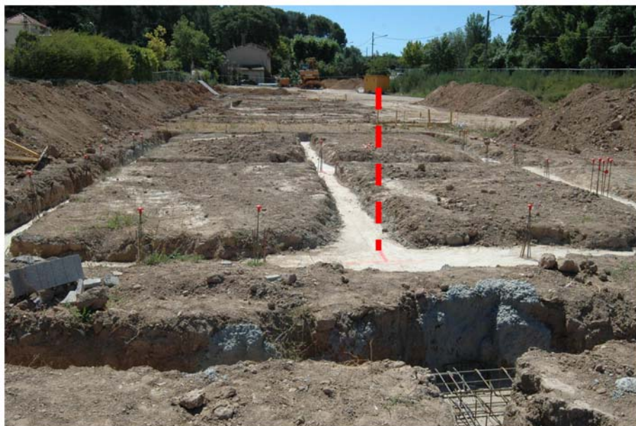
Absence d'attente de chaînage vertical (jonction mur de refend/pignon)
