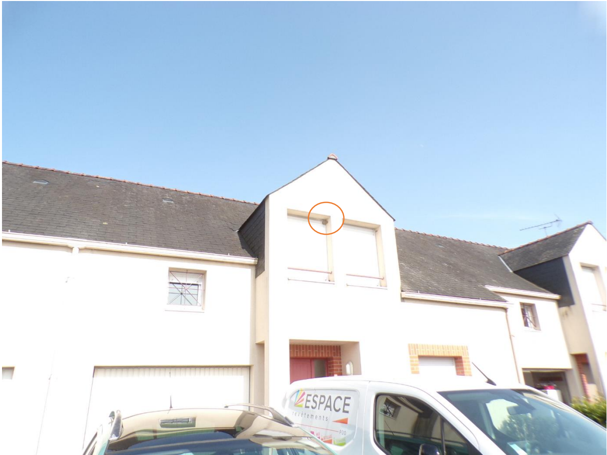
FIGURE 13 : TRACES DE NIDIFICATION DE L'HIRONDELLE DE FENETRE SUR LE 19 SQUARE DU FOUR
