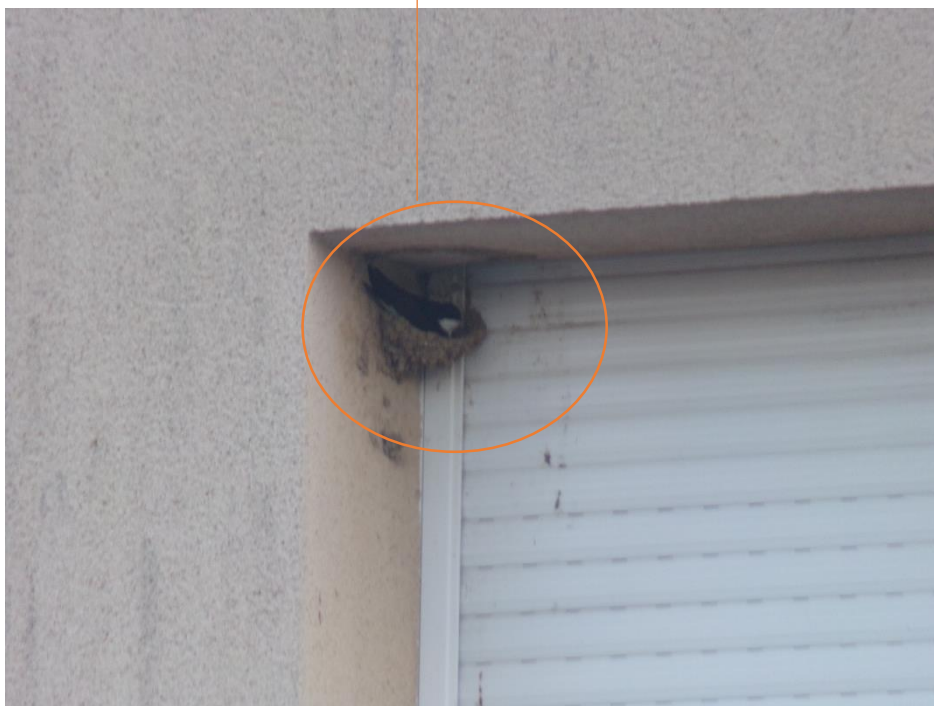
FIGURE 10 : TRACES DE NIDIFICATION DE L'HIRONDELLE DE FENETRE SUR LE 1 SQUARE DU FOUR
