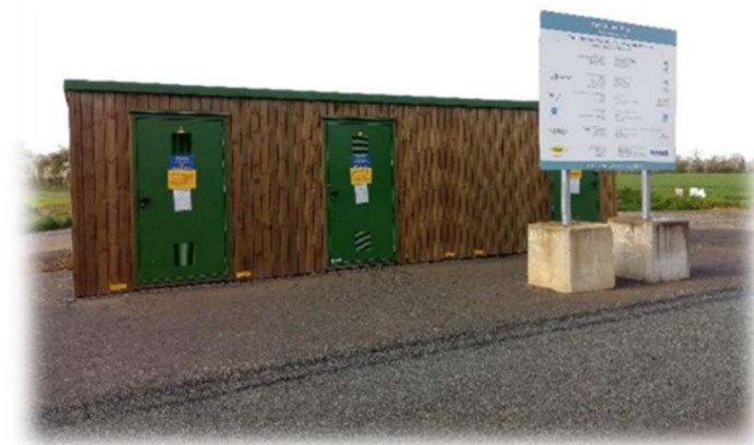
Figure 3 : Poste de livraison
