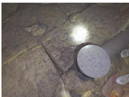
Trace de guano présente dans les combles ouest
