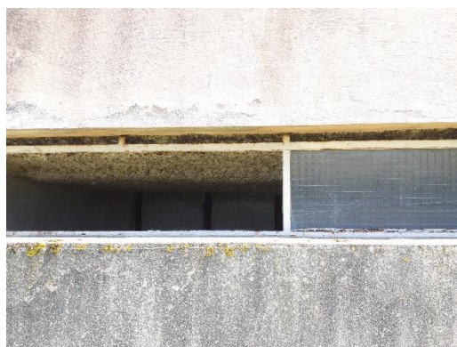
Fenêtre cassé (accès aux caves)
