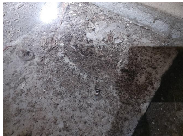
Trace de guano dans le bâtiment n°3
