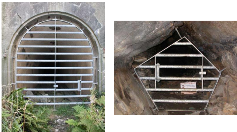
Figure 27 : Exemples de grilles de protection de gîtes à chiroptères (Source : GMB, par Yves Thiaux)
