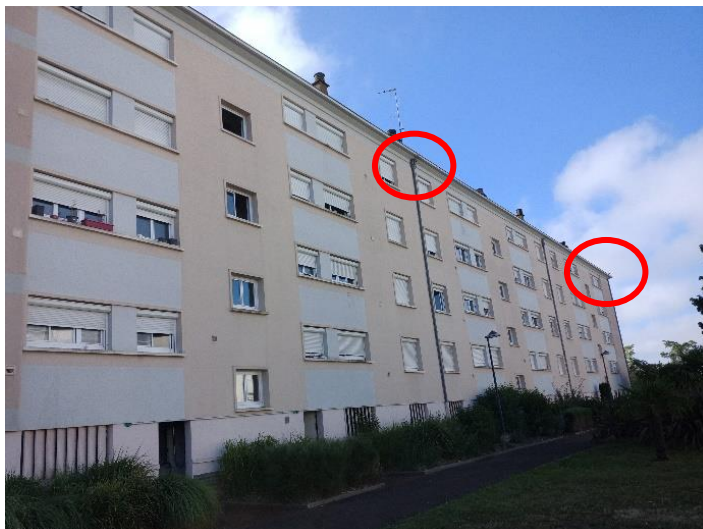
Figure 9 : cavités utilisées par les Martinets noirs sur la face ouest
