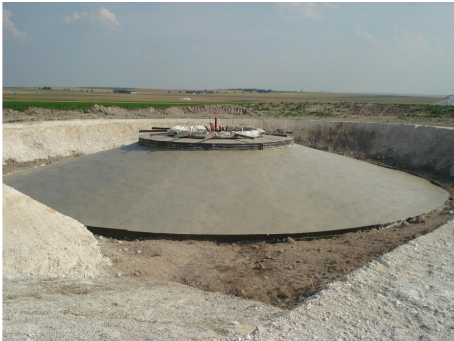
Photographie 17 : Exemple d'une fondation "massif poids" avant recouvrement (parc éolien de Germinon)
