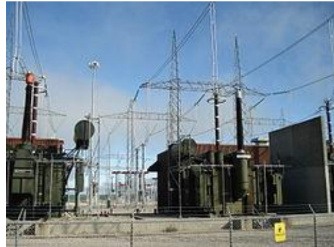
Photographie 3 : exemple de poste de transformation électrique (source : wikipédia)
