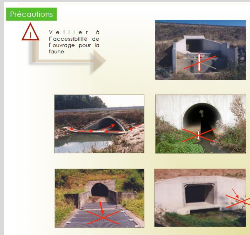
Figure 3 : Mauvaise accessibilité de l'ouvrage pour la faune
