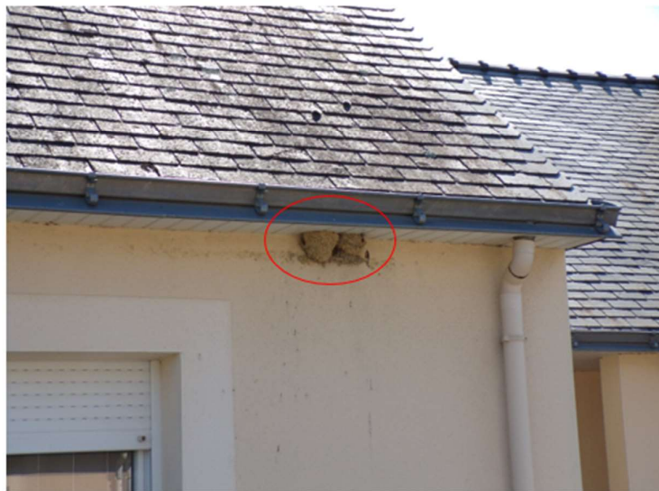
Figure 39 : Localisation des deux nids d'Hirondelles – 1 rue des Fontaines
