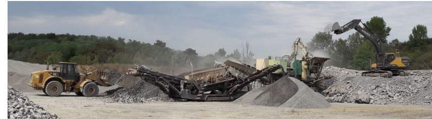
Les émissions de poussières de l'installation ▲
