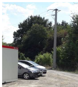
La ligne électrique alimentant le site ▶
