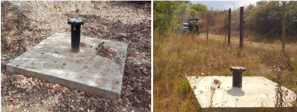
Exemple de piézomètre implanté (ici Pz F et Pz 2)
