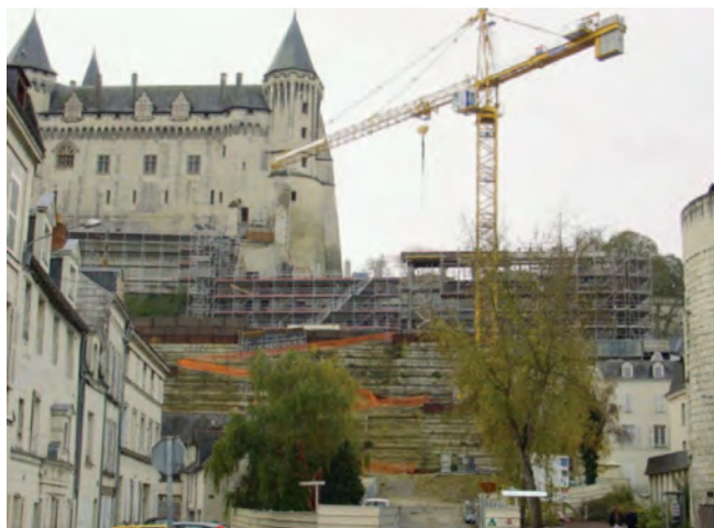
Effondrement des remparts château de Saumur
