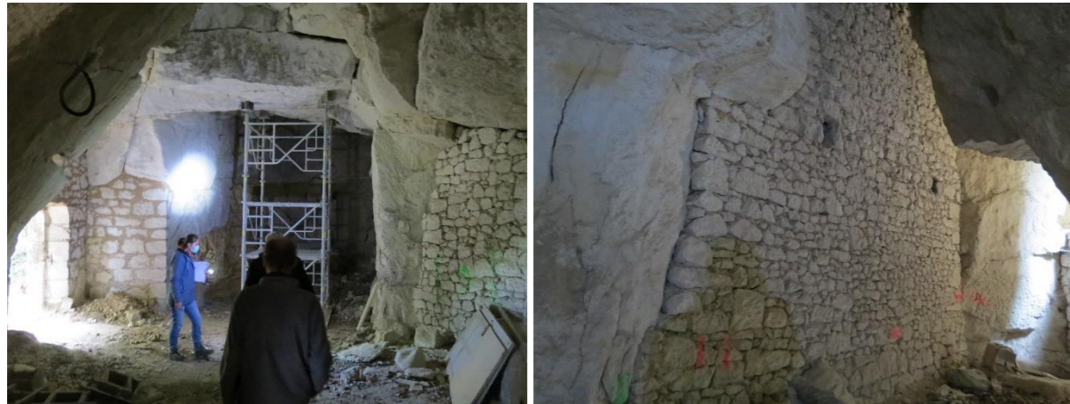
Mise en place de plusieurs tirants - paroi projetée sur mur de moellons (4-6 m de hauteur) Large zone avec plusieurs accès de dimensions variable vers un fontis : calfeutrement total impossible
