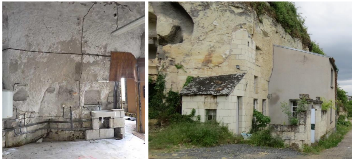
Maison troglodytique en façade du site : plusieurs accès de dimensions « réduites », mais en hauteur de type portes/fenêtres/petits interstices/fissures/cheminée : calfeutrement total impossible
