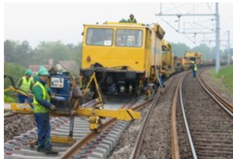
Longs Rails soudés sur traverses béton
