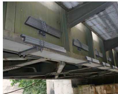
Absorbeur sur platelage
